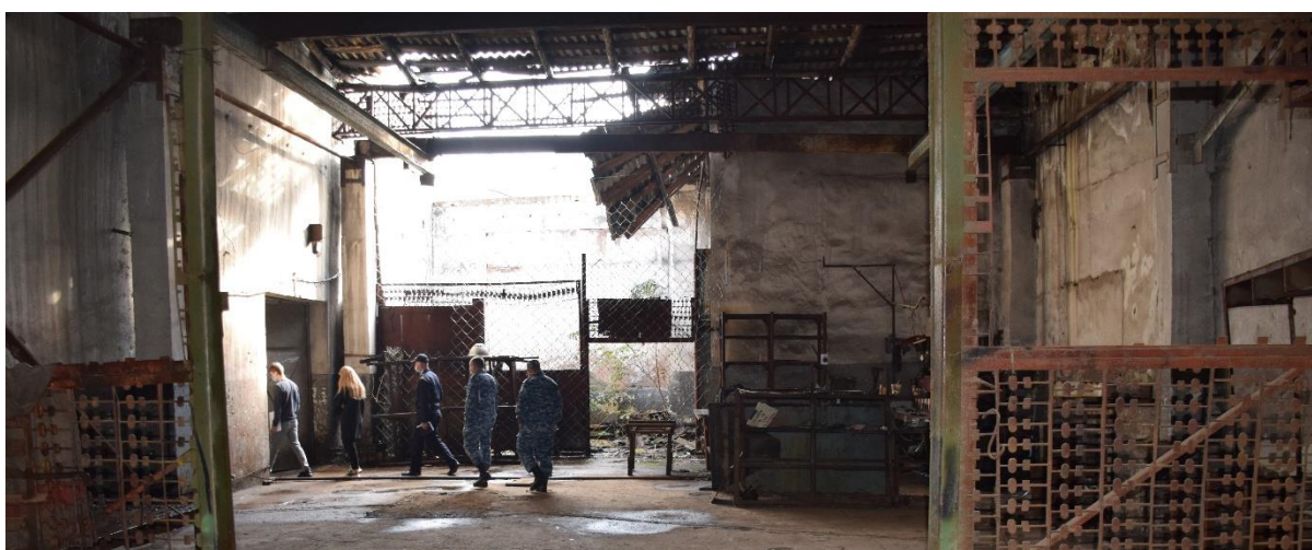
Foto 5 Spațiile de lucru sunt libere și necesită reparații capitale, începând cu acoperișul care curge
